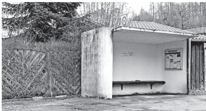
Keine Schönheit, aber jetzt wenigstens frei von Containern und Glasscherben: Die Bushaltestelle in der Friedrichstraße in Oberreichenbach.
