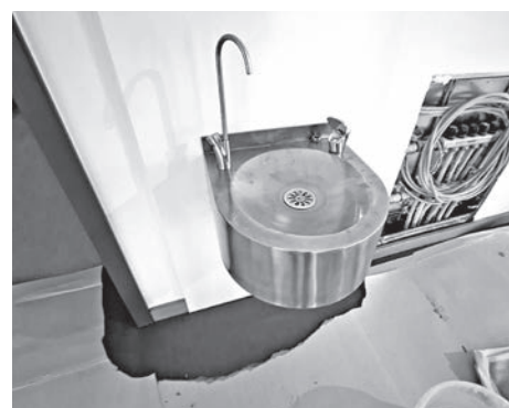
Der kleine Trinkbrunnen wartet in der Aula im Erdgeschoss auf durstige Kinder.
