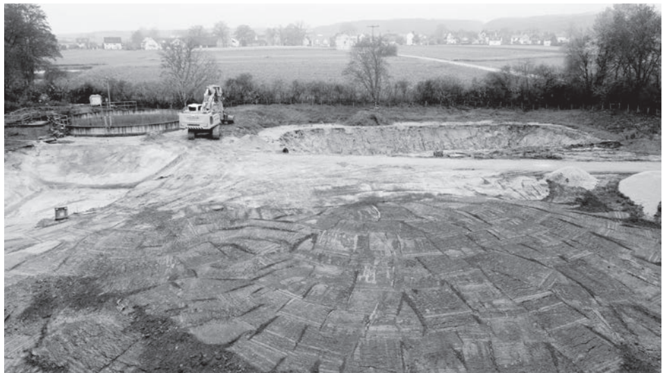
Schon seit Ende Juli wird von der mittlerweile abgerissenen Kläranlage Haag das Abwasser provisorisch per Tauchpumpe und Druckleitung unter der Autobahn A6 durch nach Schwabach gepumpt. Hier entsteht ein modernes Pumpwerk mit Regenüberlaufbecken. (Foto: ropi)
