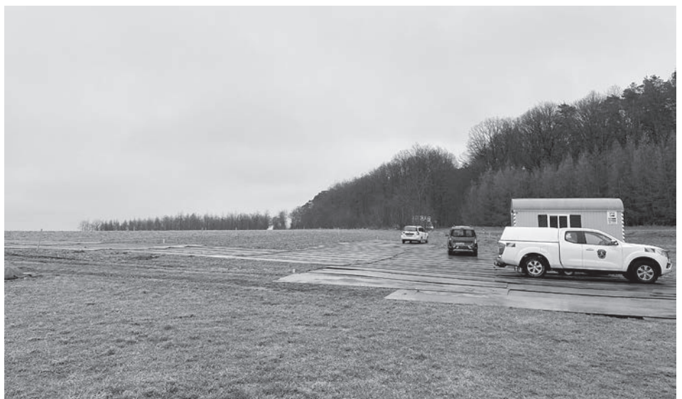
Derzeit wird das Gelände des künftigen Solarparks Kammerstein auf etwaige Sprengstoffe und andere Kampfmittel untersucht, denn 1945 war hier ein britischer Bomber abgestürzt. Ab Mitte Februar sollen hier die eigentlichen Arbeiten für den Solarpark beginnen. (Foto: RoPi)
