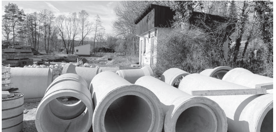
Die Kläranlage Barthelmesaurach wird derzeit in ein Pumpwerk umgebaut. Im Altort Barthelmesaurach werden demnächst die Abwasserkanäle per TV-Befahrung kontrolliert. (Foto: RoPi)
