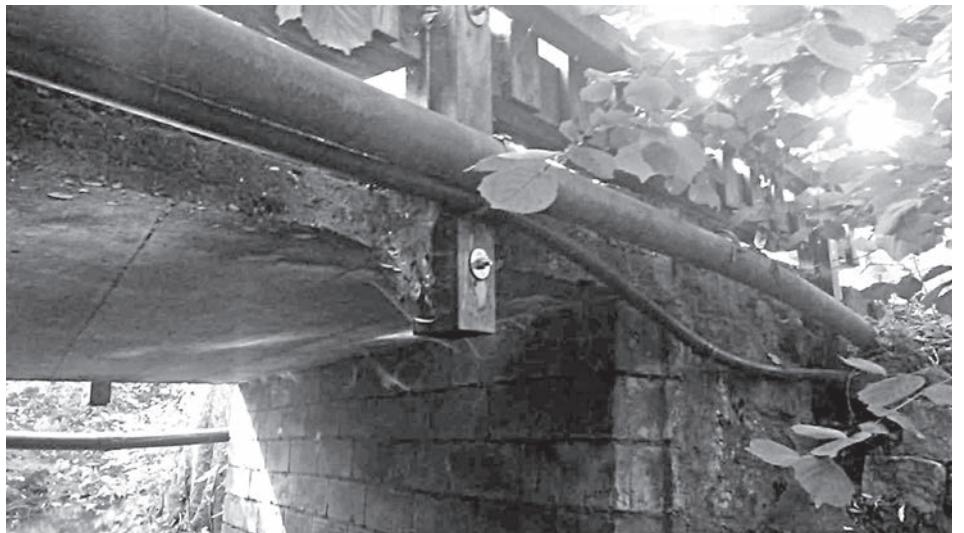
Der Brückenunterbau ist nicht mehr ganz tauf fris ch.
