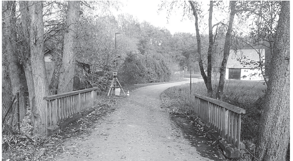
Die Brücke über die Aurach bei Hasenmühle (hier vor den Rodungsarbeiten im November 2022), die den kleinen Ortsteil mit Barthelmesaurach verbindet, ist marode. An ihrer Stelle soll 2023 oder 2024 ein Ersatzneubau erfolgen. (Foto: Ingenieurbüro Klos)
