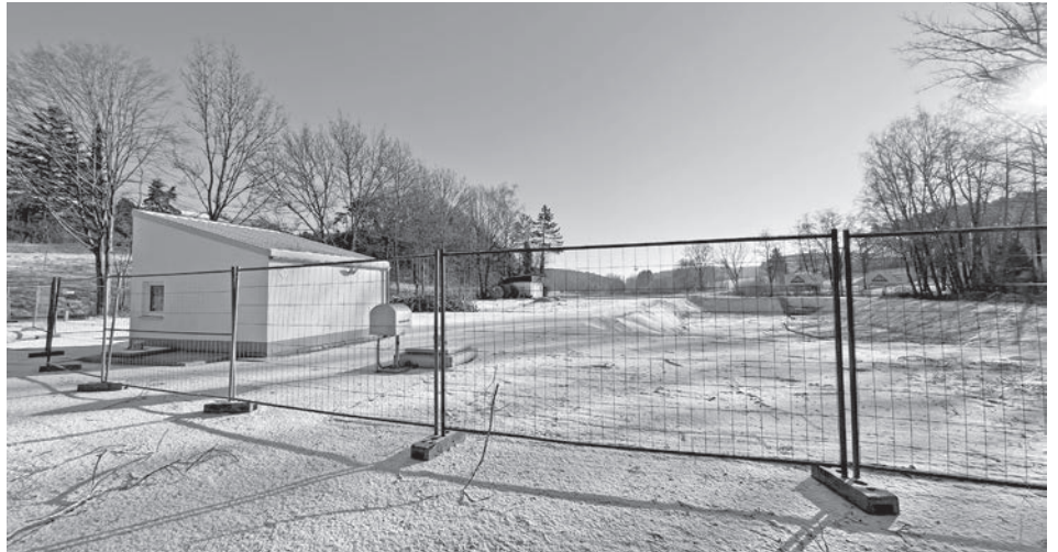
Das neue Abwasser-Pumpwerk Barthelmesaurach ist fertig. Der Gemeinderat genehmigte die Kosten für eine neue Einzäunung mit Tür und Tor. (Foto: ropi)
